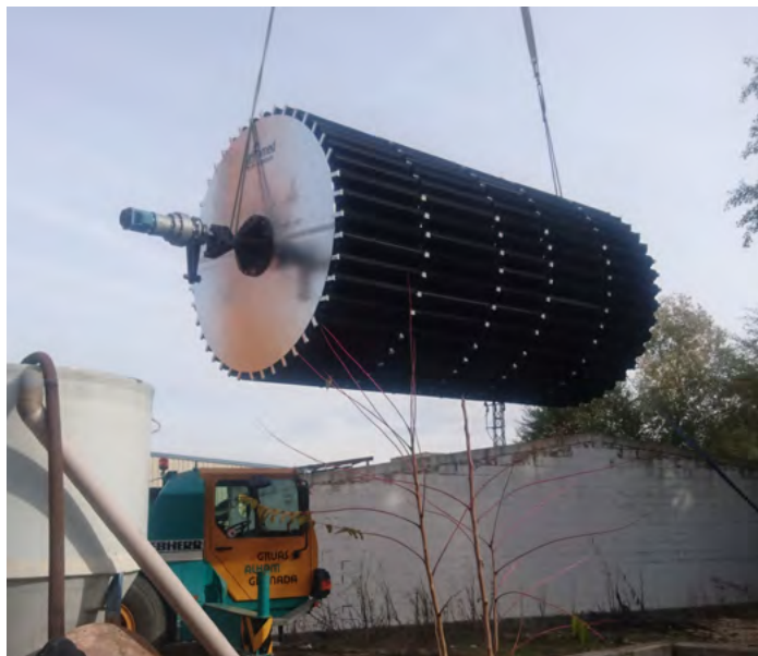
INSTALACIÓN DE BIODISCO EN TRES ETAPAS
